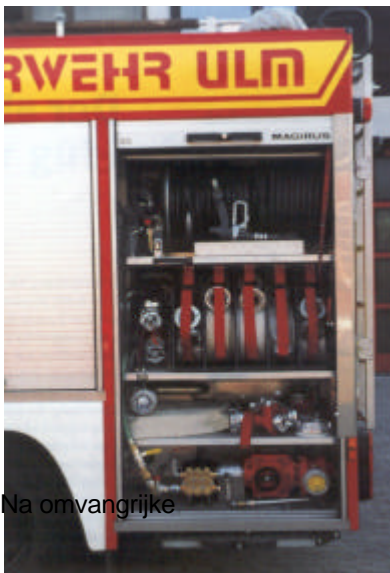
Foto 2 (links): Inbouw van het bijmengsysteem in de gereedschapsruimte G5 van de HTLF (zie tekst). Daarboven is het snel inzetbare verdeelstuk te herkennen.
